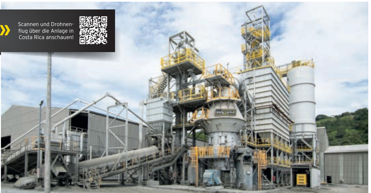
R2G 2500 C-4: Das Herzstück der ready2grind-Anlage in Costa Rica bildet wie immer eine MVR-Mühle mit vier Mahlwalzen
